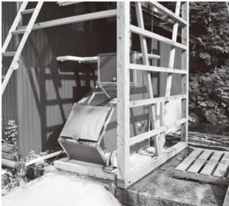
▲三ツ又温泉で導入した薪ボイラー
